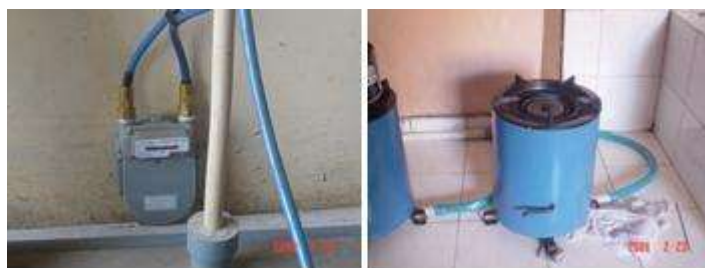
Gambar 6. Alat pengukur gas kumulatif dan komponen kompor biogas
